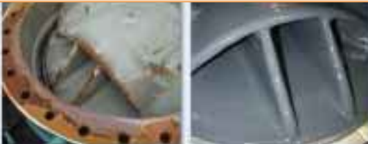
Поврежденный дроссельный клапан – до и после ремонта
