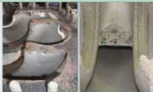
Пример точечной коррозии
