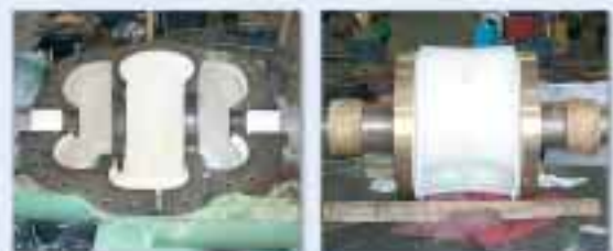
Ремонт поврежденного коррозией вала с помощью Loctite® 3478 Superior Metal. После отверждения можно механически обработать восстанавливаемые поверхности. Окончательно покрываем все рабочие поверхности составом Loctite® Nordbak® 7228 Brushable Ceramic White (сертифицированным для использования в контакте с питьевой водой)
